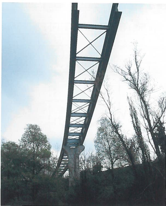
Photo 6 : 1 ère moitié du tablier après le lançage / First half bridge after launching
